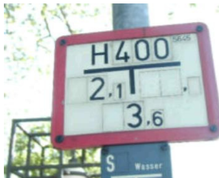
Hinweisschild eines Unterflurhydranten
