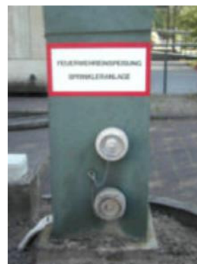
Einspeisung für eine Sprinkleranlage
