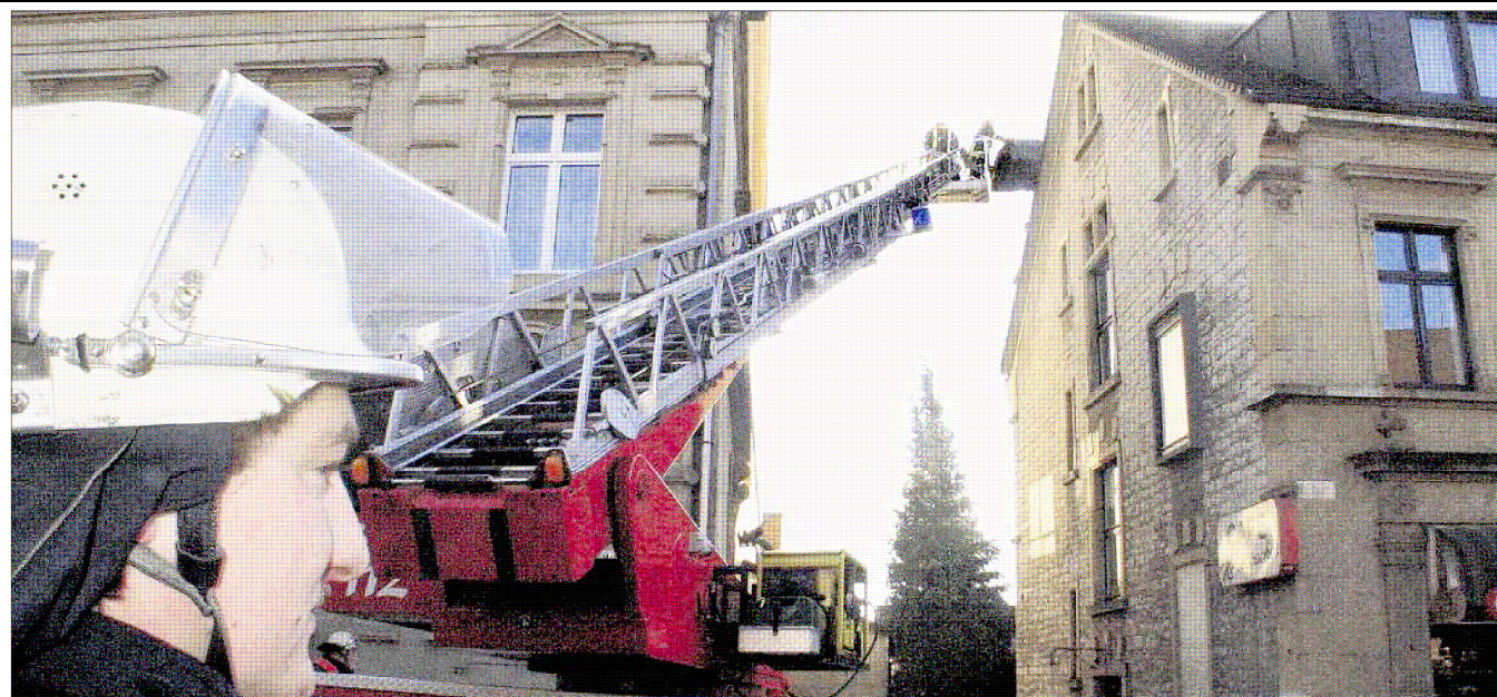
WÄHREND DES STURMS entfernten Brettener Feuerwehrleute ein Stück eines Daches in der Fußgängerzone, damit kein weiterer Schaden durch umherfliegende Teile entsteht.
